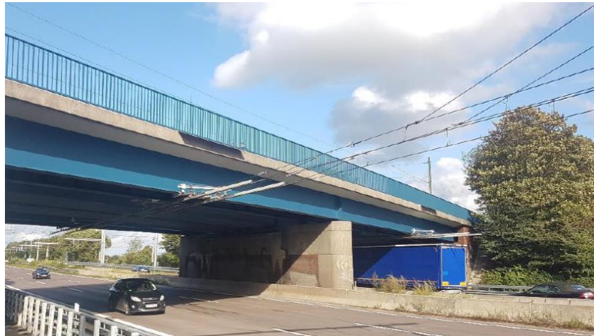
Afbeelding 4.4 Bovenleiding onder laag viaduct [e-highway Siemens]
