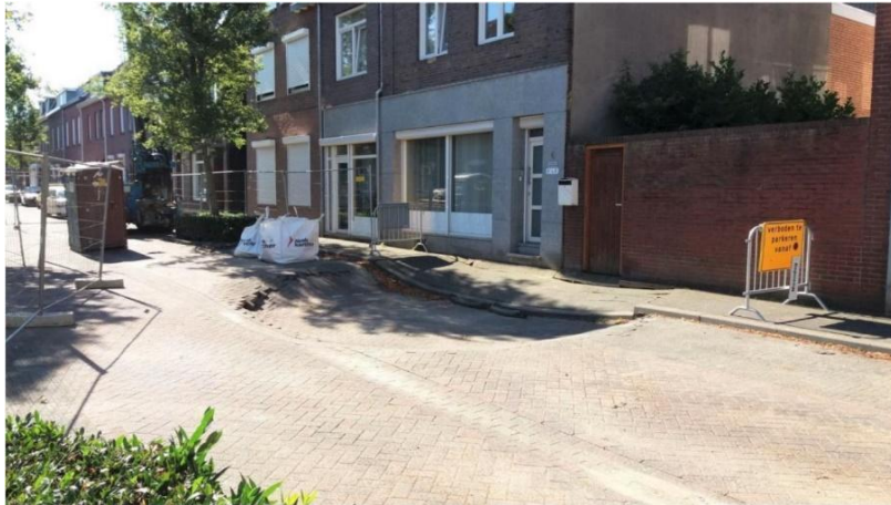
Abb. 2: Tagesbruch auf Schacht DOM 37 am 23.07.2020 gegen 10:00 Uhr
