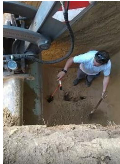
Figuur 48. Na het optreden van spoelingsverlies bij boren in een drempel is deze uitgegraven. Een grote open sleuf bleek aanwezig op een paar meter diepte (foto: Jaap Spaans, Informatiecentrum).
