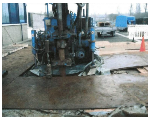
Figuur 33 Kleine zetting (verzakking) van de boorinstallatie (bron ingenieursbureau IHS).
