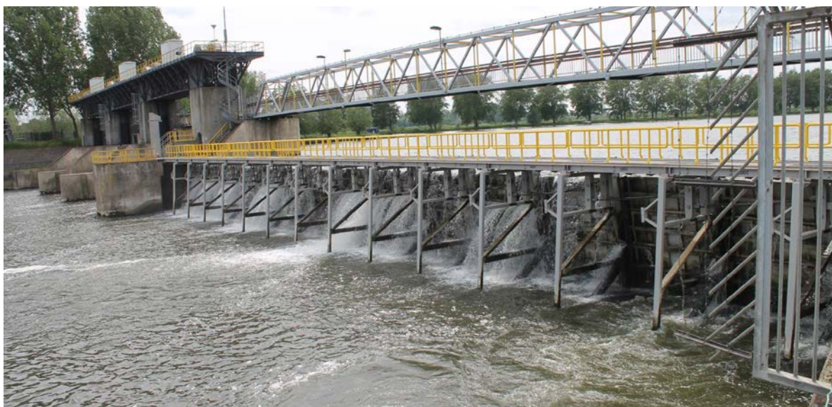
Figuur 27: Stuw Linne met lekverlies tussen de schotten door
