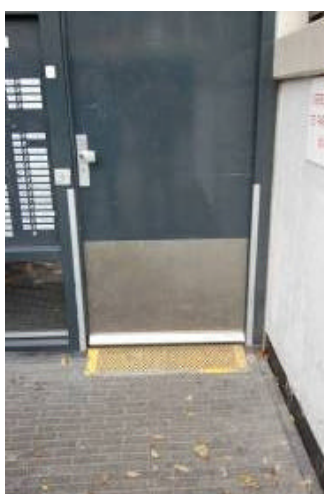
Op afstand bedienbare toegangsdeur portaal
