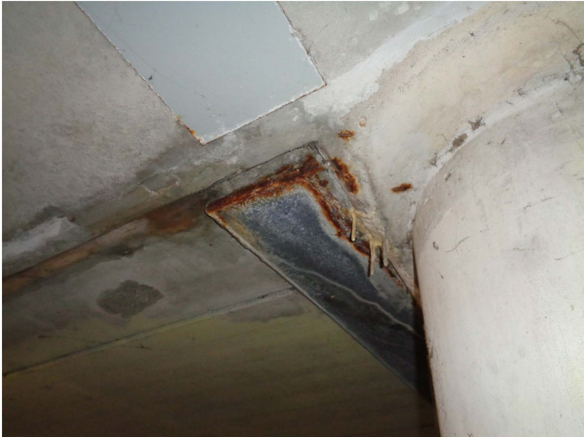
▲ Figuur 14: Roestvorming op de ligger onder de hellingbaanconstructie in 2023. (Bron: onderhoudsadviesbureau van de huidige gebouweigenaar)
